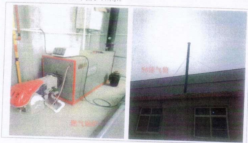
图 3-4 燃气锅炉现场照片
