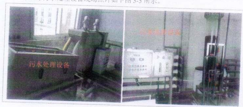
图 3-4 污水处理设备现场照片
