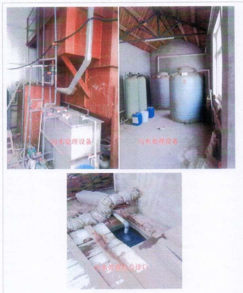
图 3-4 污水处理设备现场照片
